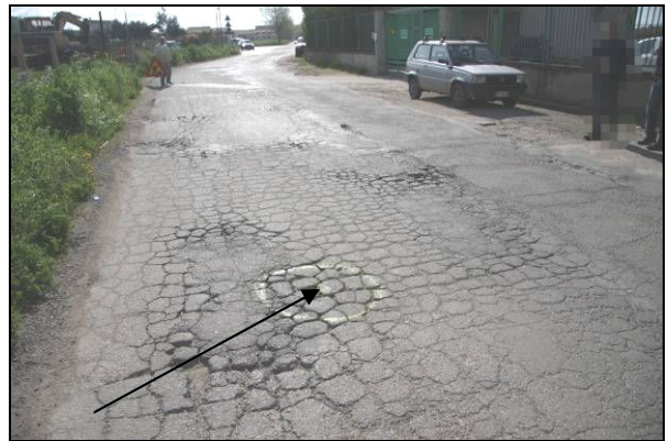
Immagine 4.12 - Pozzetto D nella via Tuveri.
