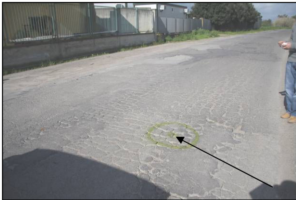
Immagine 4.11 – Pozzetto D nella via Tuveri.
